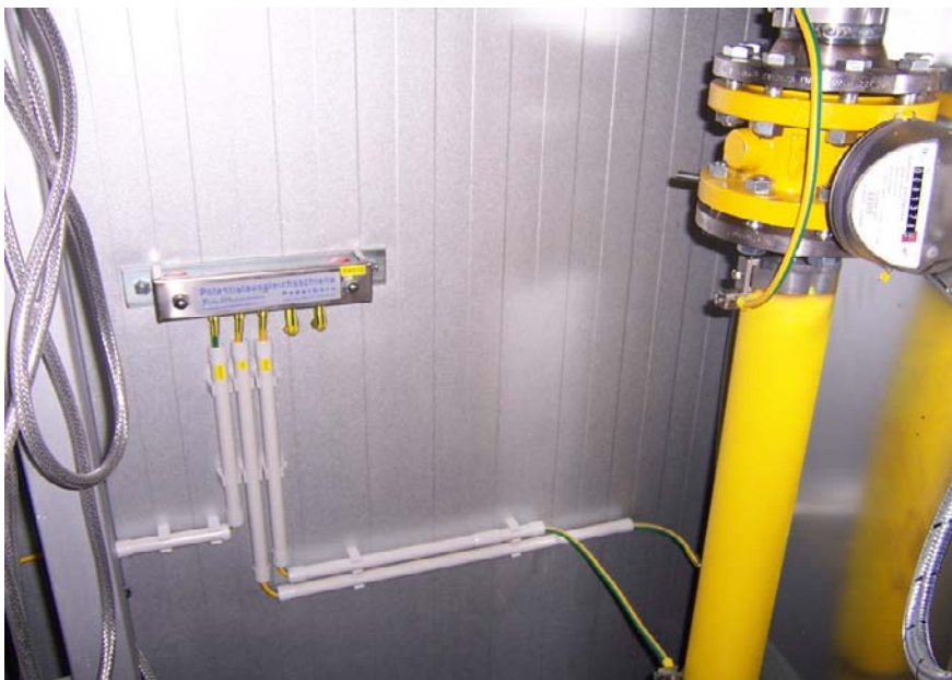
Bild 2: Potentialausgleichsschiene mit Erdungsanschlüssen
