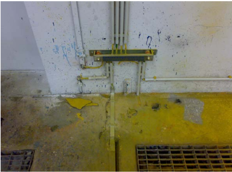
Bild 4: Diverse Erdungsanschlüsse an eine Potentialausgleichsschiene in einer Lackiererei
