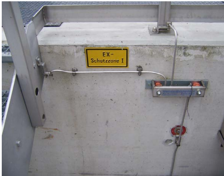
Bild 4: Diverse Erdungsanschlüsse an metallene Bauteile in einer Kläranlage
